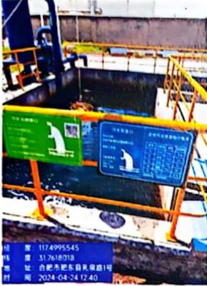
污水总排放口
